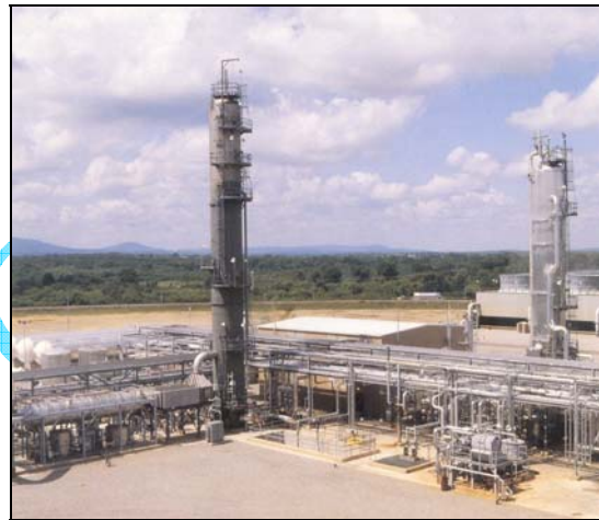
Μονάδα δέσμωσης CO 2 από καυσαέρια. (ABB LUMMUS CREST)
