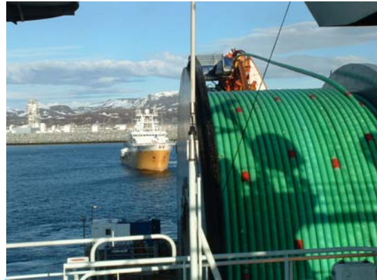
Τοποθέτηση αγωγού μεταφοράς CO 2 από τερματικό σταθμό φυσικού αερίου στη Β. Νορβηγία προς το πεδίο Snøhvit (φωτ. STATOIL).
