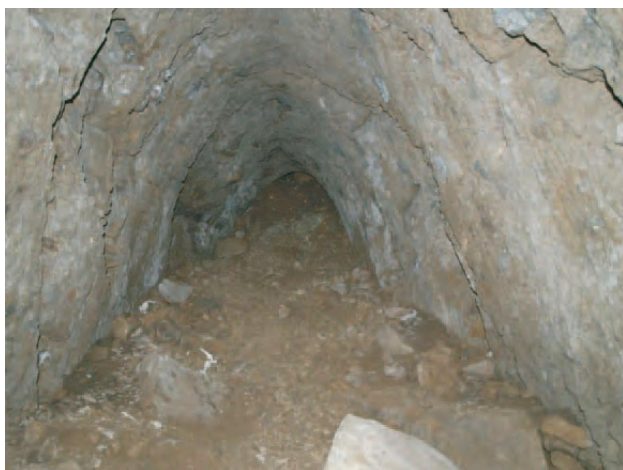
Obr. 4. Charakter „gotické“ chodby. Laharové aglomeráty ve stropě nejsou soudržné a uvolněné bloky vypadávají. Foto P. Kycl.
