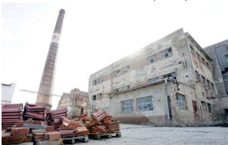
obr.1 zdevastované budovy cihelny
