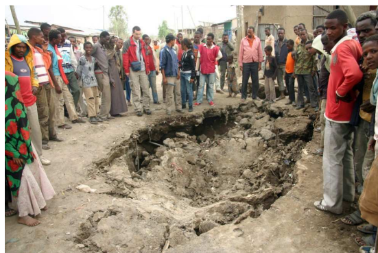
Obr. 10. Propad stropu kaverny vytvořené subterénní erozí v
