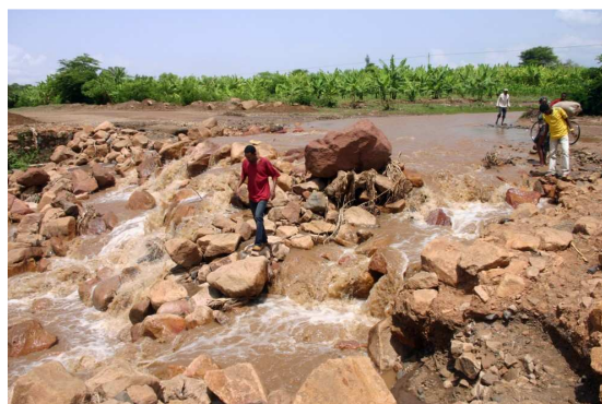
Obr. 8. Narušení silnice u Arba Minch změnou říčního koryta na aluviálním vějíři.
